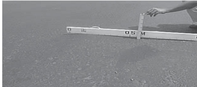
Gambar 2. 5 Kerusakan Alur ( Rutting )
