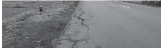
Gambar 2. 2 Kerusakan Retak Pinggir ( Edge Crack )
