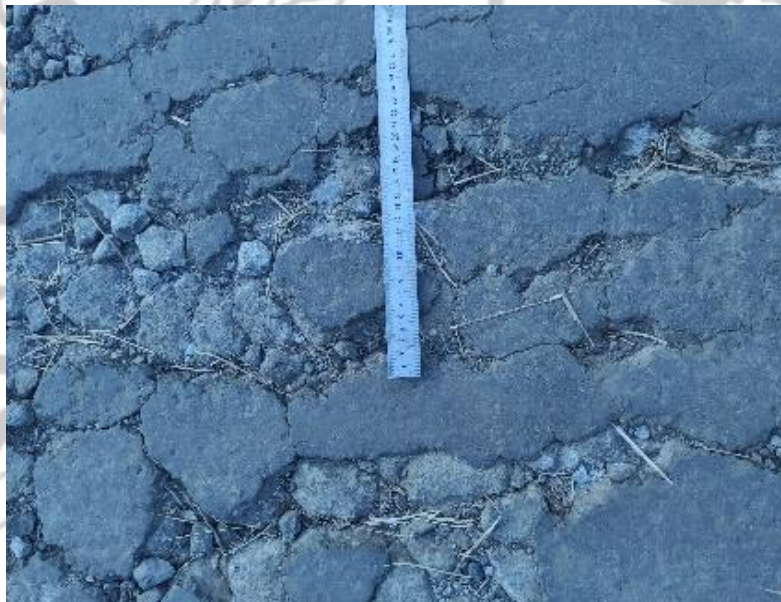
Gambar 4.4 Lebar Retak STA 0+900 – 1+000
