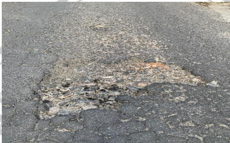
Gambar 4.5 Kerusakan Lubang STA 1+400 – 1+500
