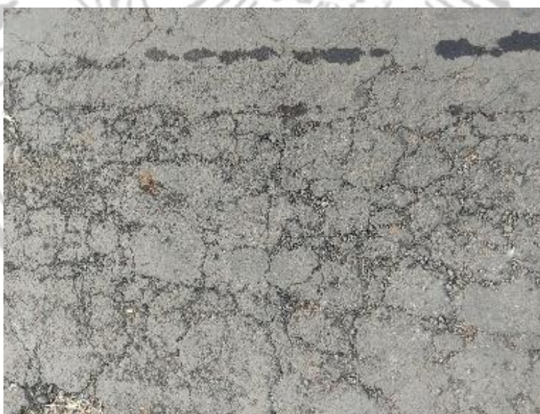
Gambar 4.3 Kerusakan Retak Kulit Buaya STA 0+400 – 0+500
