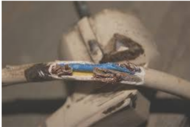
Gambar 7.14. Kabel tembaga putus didalam isolasi
