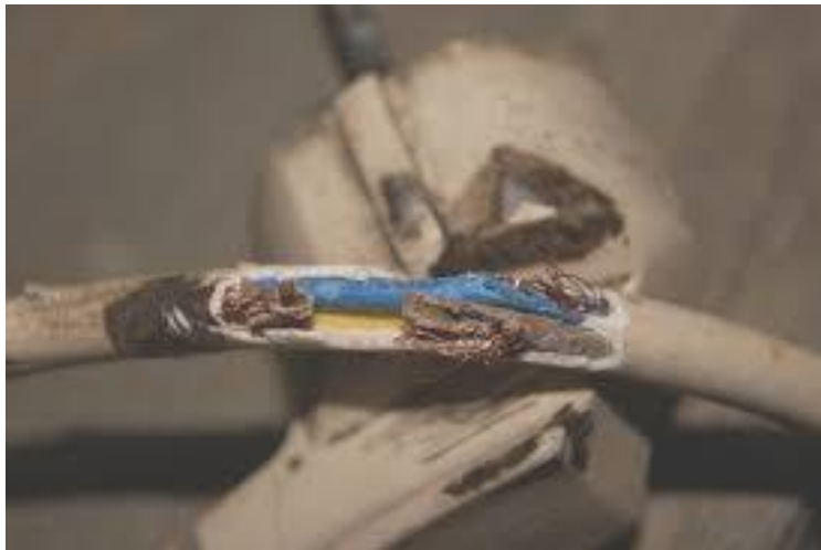
Gambar 7.14. Kabel tembaga putus didalam isolasi
