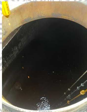
Gambar 17. Bagian dalam Storage Tank
