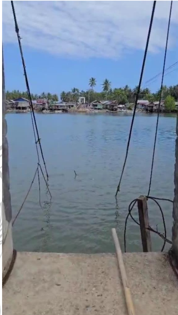
Gambar 2. 4 Jembatan Salu Putus Akibat Hujan
