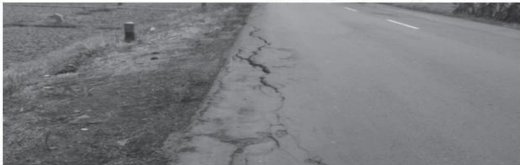
Gambar 2. 3 Kerusakan Retak Pinggir
