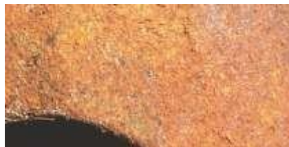
Gambar 2.6 Korosi Merata pada Permukaan Logam
